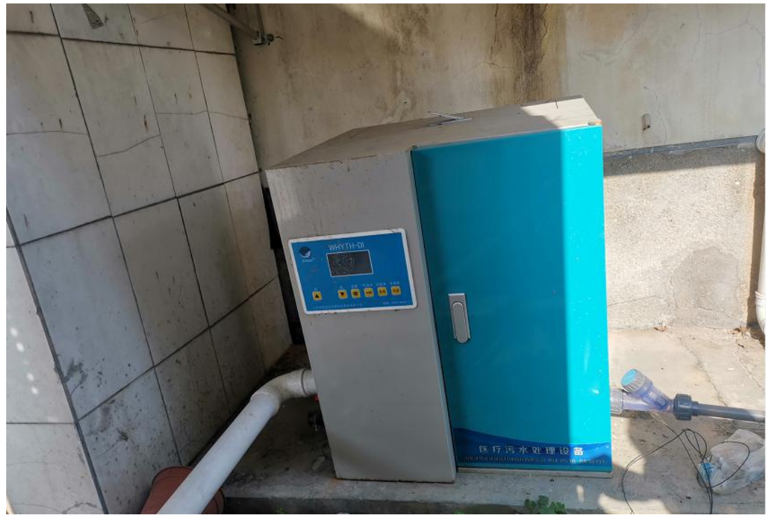
污水处理设施
