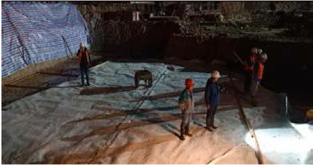
事故应急池及初期雨水池
