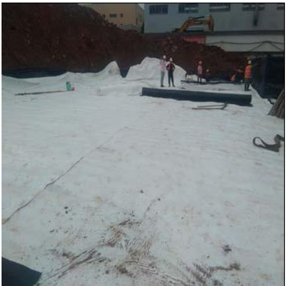
烟气处理区域集水池
