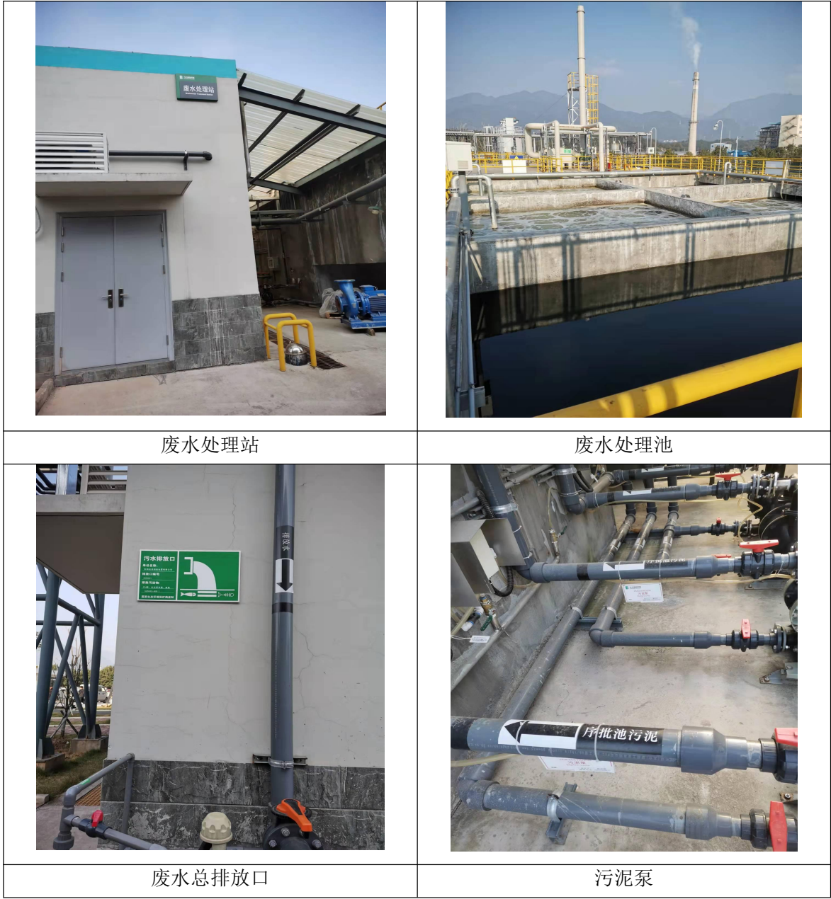
图 4.1-4 项目厂区内废水收集、处理设施照片
