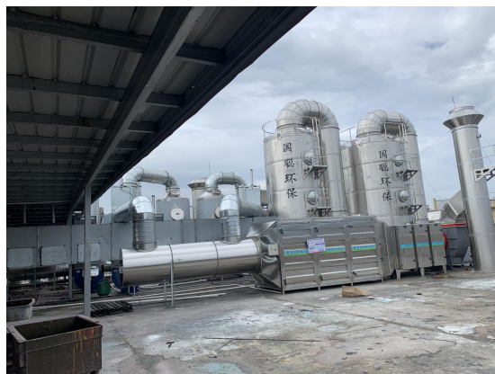
水喷淋+干式过滤+UV 光催化（水漆废气处理设施）
