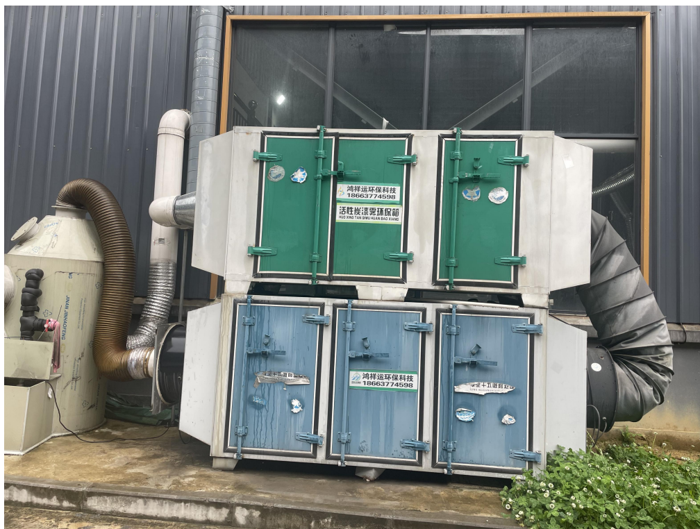
水幕喷淋+过滤棉脱水+二级活性炭吸附
