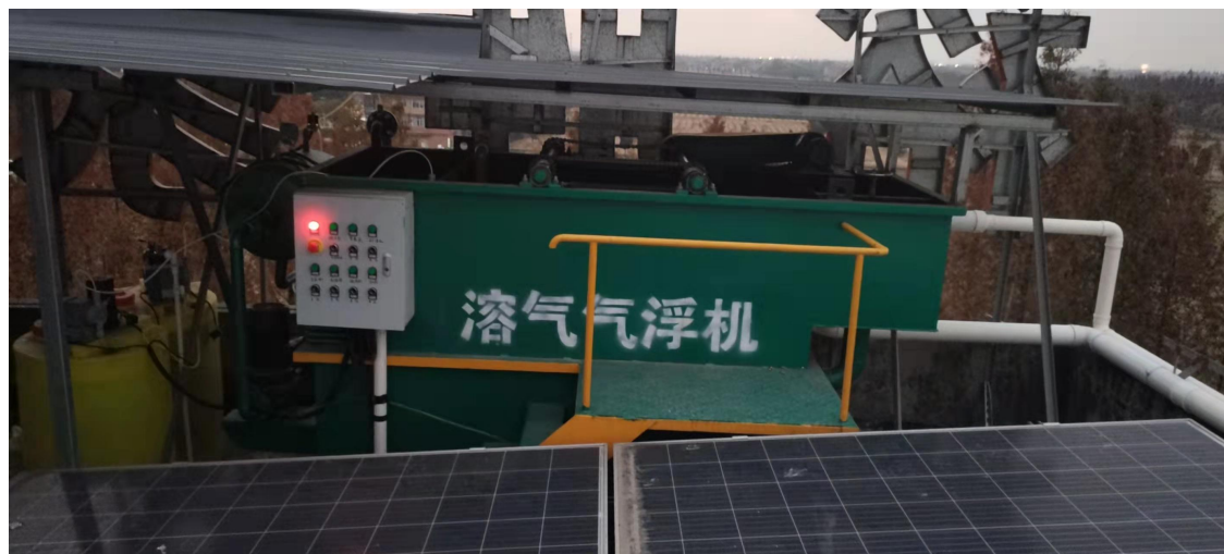
废水处理设施
